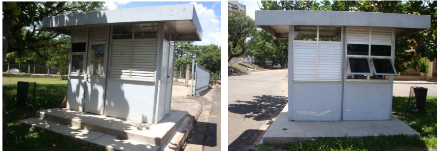
Instalação de guarita na SCPRAES – Seção de Prática Esportivas - portão da Avenida Pádua Dias
