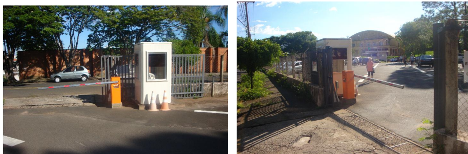
Figura 17 - Cancelas para controle de acesso: SCPRAES para Av. São João e Av. São João para SCPRAES.
