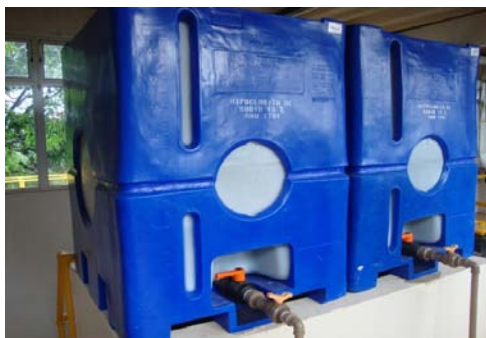
Figura 29 - Contentores para armazenagem de produtos químicos
